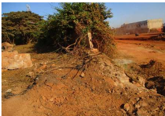
Côté Nord-Est du mur de clôture endommagé par les travaux de l'échangeur
