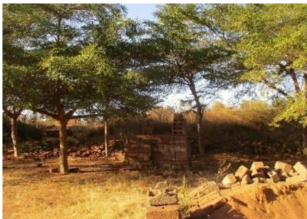
Côté Sud-Est du mur de clôture endommagé par le ruissellement de l'eau
