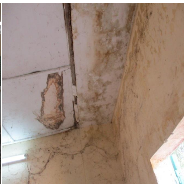
Etanchéité du magasin de stockage Diéma
